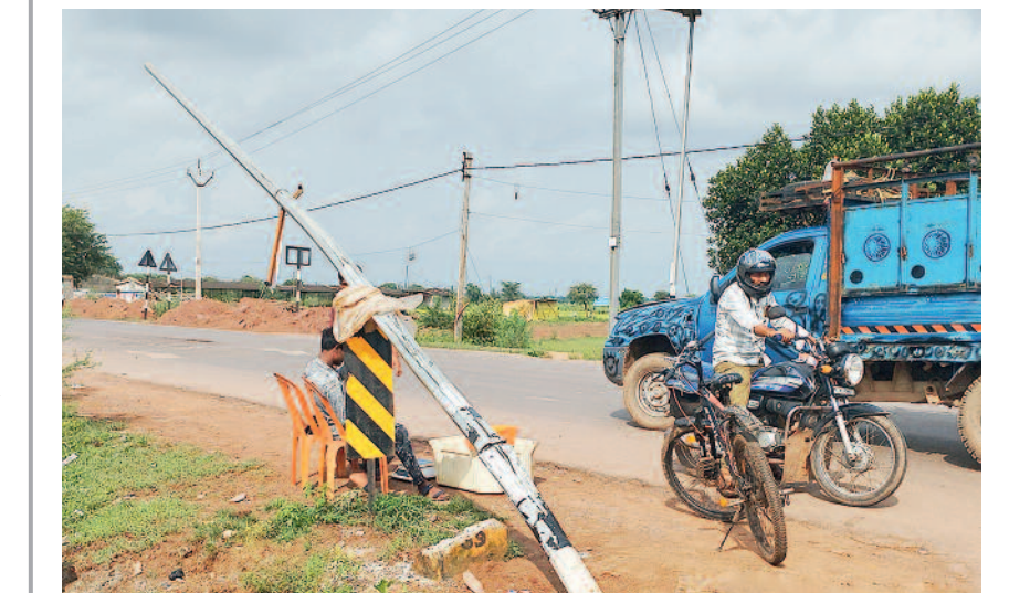
अभनपुर। लापरवाही,कभी भी हो सकता है हादसा खोराप मेन रोड जरहू पुलिया के पास अनियंत्रित ट्रक ने सोलर लाइट पोल तोड़ा, टुक हटाय़ा गया पर पोल अब भी टढ़ा लटक रहा है।
